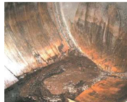
Cuve encrassée dû au vieillissement du carburant.
